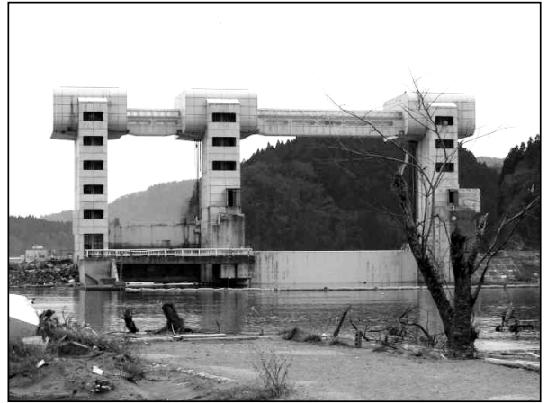
図－5 大津波により被災した水門 (岩手県陸前高田市)
